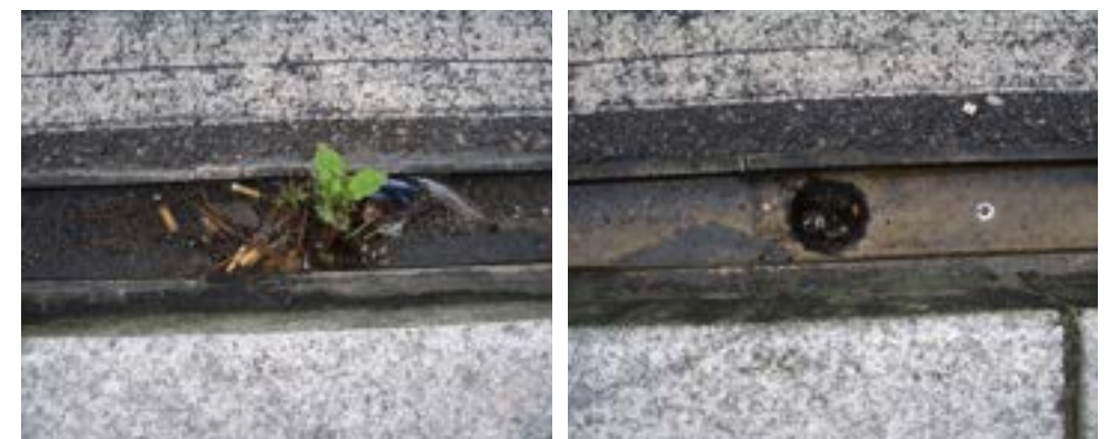
Figura 8. Desagües y caz del puente de La Toja (2004) antes de las operaciones de mantenimiento.
