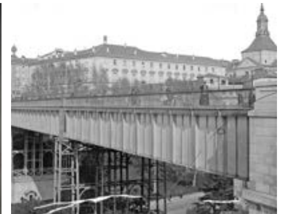
Figura 204. Vista diurna lateral del viaducto antiguo sobre la calle Bailén, en Madrid.
