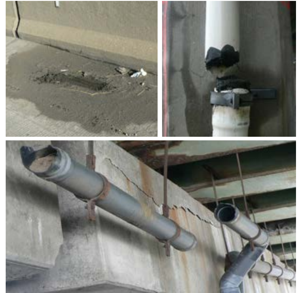
Figura 7. Sumidero en mal estado, canalones y bajantes atascados y rotos por el hielo en la Indiana Toll Road (2006).
