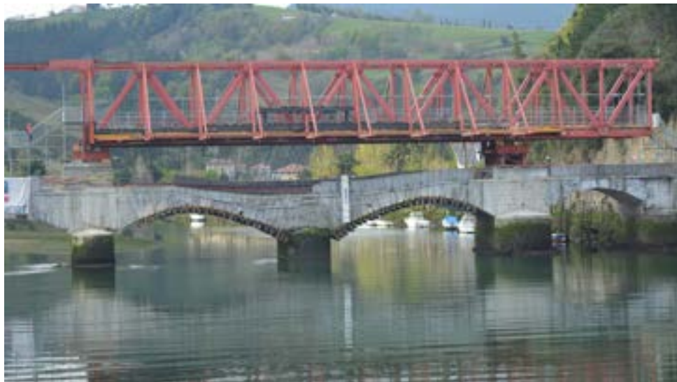
Figura 9. Intervención en el puente de Deba en la fase de emergencia, de consolidación de la ruina, previa a la restauración.
