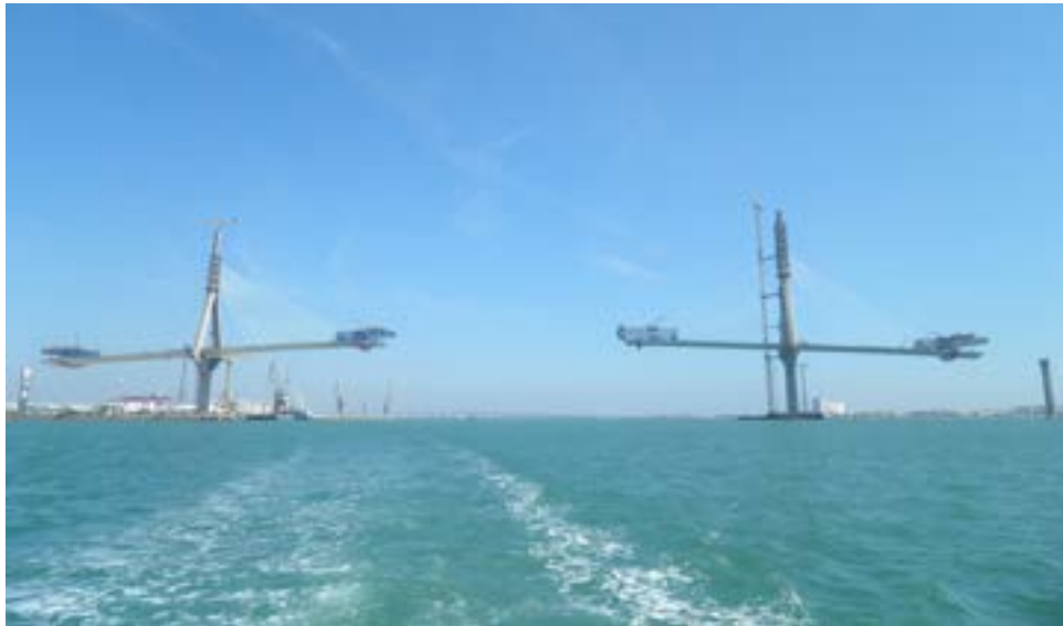
Figura 182. Construcción del Puente de la Constitución de 1812 sobre la bahía de Cádiz, 2015.
