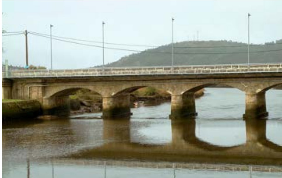
Figura 14. Alzado parcial de aguas arriba del puente de Ponteceso tras la restauración de la estructura.
