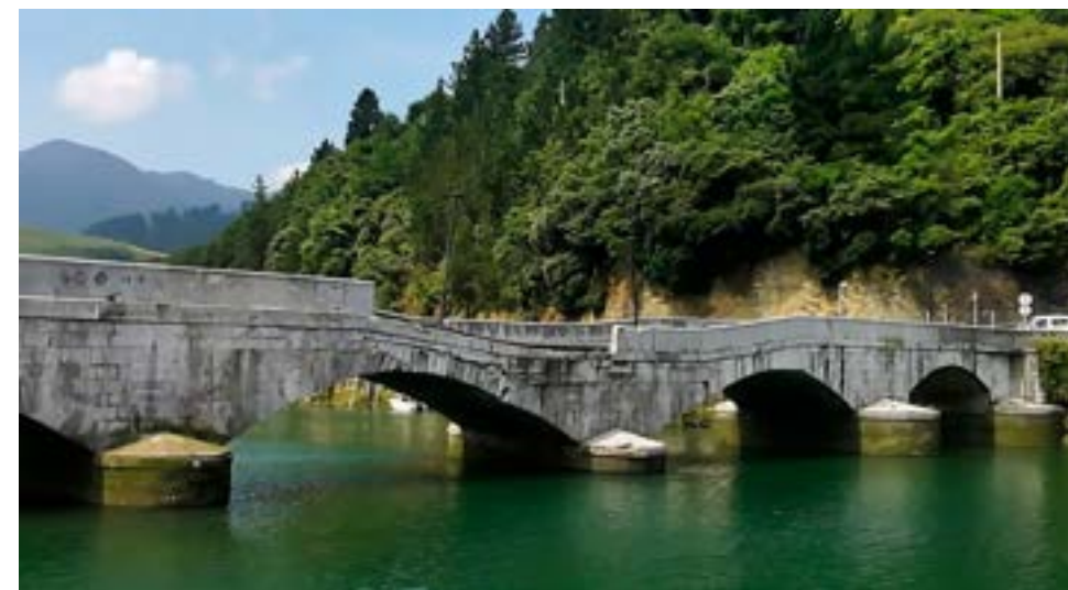
Figura 129. Colapso del puente debido a la acción de bivalvos xilófagos en la cimentación.
