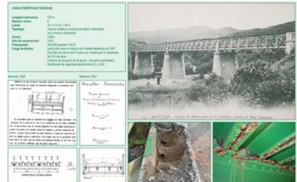
Figura 5. Panel divulgativo elaborado para explicar (2020) la necesidad de intervenir en el puente sobre el Jándula (Jaén), A-6177 p.k. 22+300.
