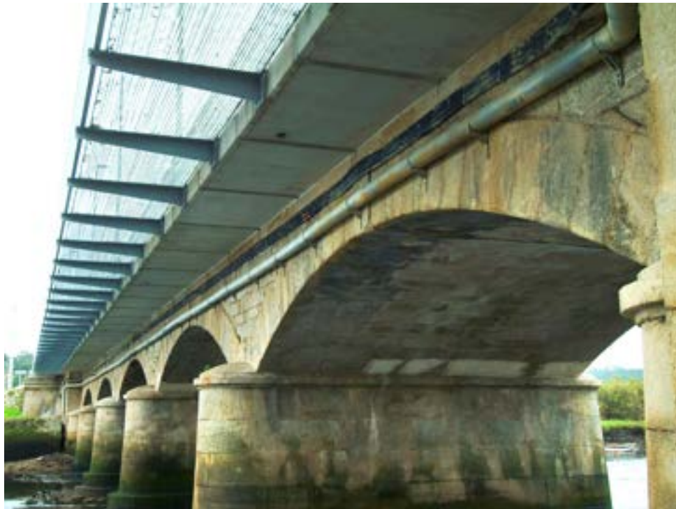
Figura 15. Vista inferior del puente de Ponteceso, en el que se aprecia el ensanche parcialmente aligerado de la plataforma.
