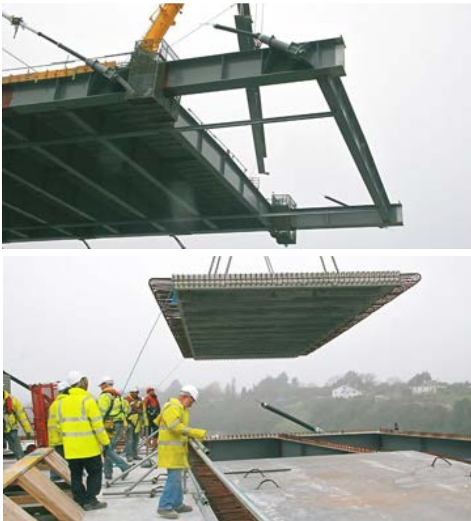
Figura 178. Estructura metálica (arriba) y losas prefabricadas del Puente sobre el río Suir, Waterford.
