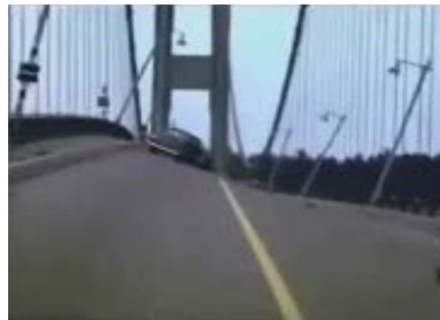
Figura 193. Puente de Tacoma. Amplificación de la vibración.
