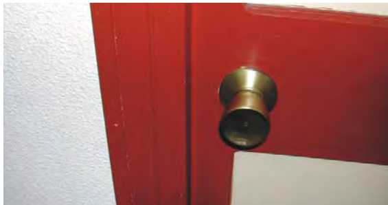
Figura 256. Manilla inadecuada. . Fuente: Socytec (fotografía).
