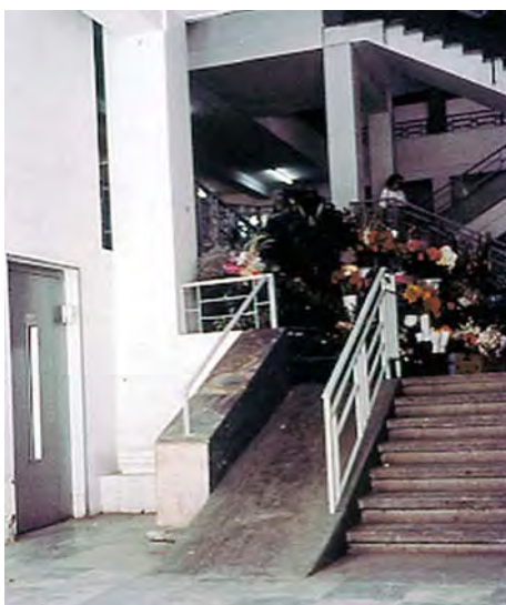
Figura 307. Rampa trampa debido a una pendiente excesiva. Fuente: Socytec (fotografía).
