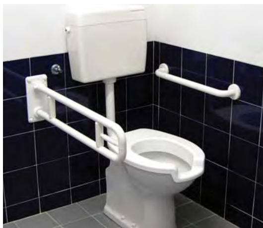
Figura 217. Ejemplo de disposición del inodoro y de las barras de apoyo. Fuente: Socytec (fotografía).
