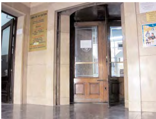
Figura 157. Puerta giratoria totalmente inaccesible. Fuente: Socytec (fotografía).
