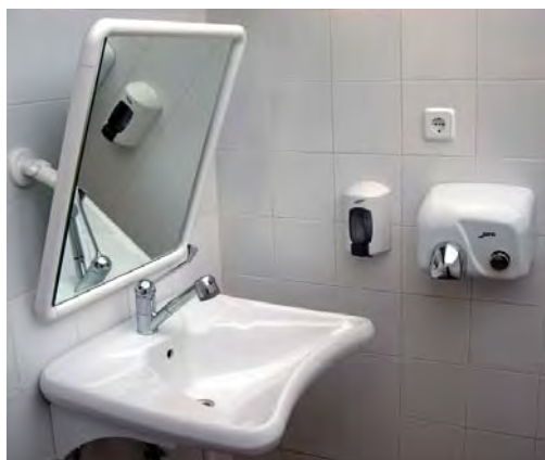
Figura 213. Ejemplo de una buena disposición de los elementos sanitarios. Fuente: Socytec (fotografía).
