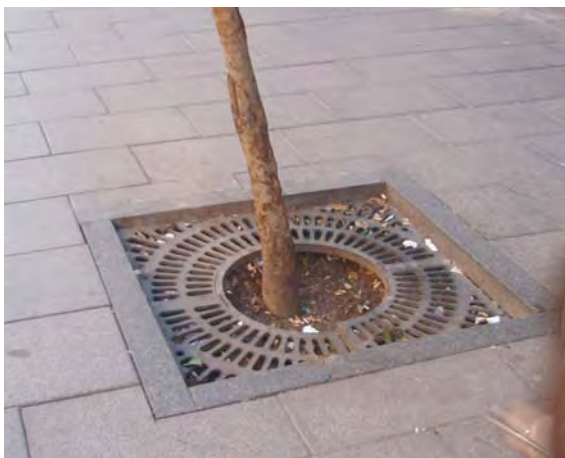
Figura 151. Práctica mejorable: alcorque mal colocado, sin enrasar con el pavimento. Fuente: Socytec (fotografía).
