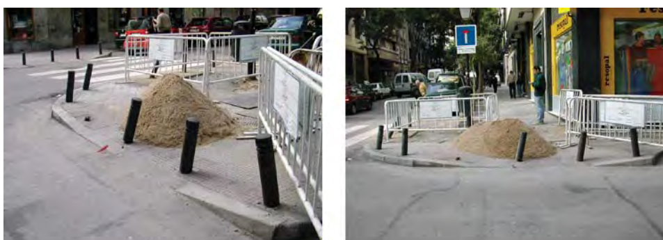
Figura 144. Pésima disposición de acopios, vallas delimitadoras y bolardos en mal estado; todo ello relega al peatón y le expone ante cualquier eventualidad. Fuente: Socytec (fotografía).
