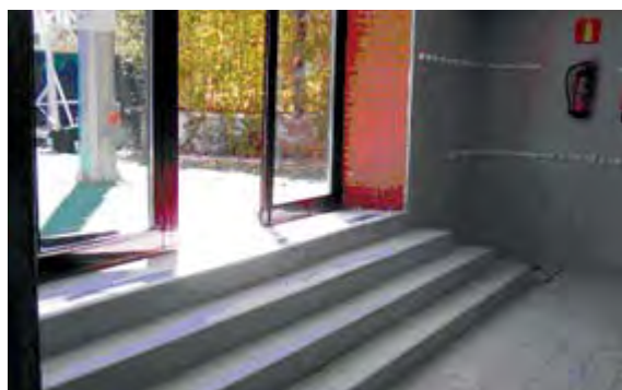
Figura 306. Acceso con desniveles sin ninguna opción alternativa accesible. Fuente: Socytec (fotografía).
