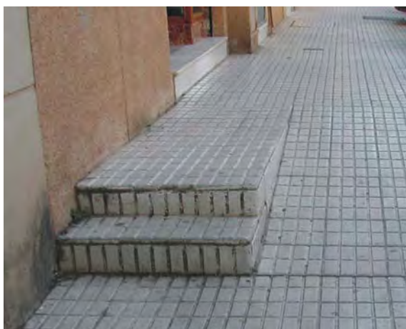
Figura 149. Práctica mejorable: Dos escalones aislados que invaden parte del ancho de la acera. Fuente: Socytec (fotografía).
