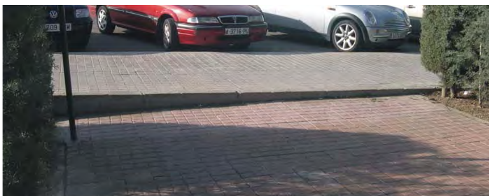
Figura 153. Práctica mejorable: desnivel salvado por el escalón en vez de rampa. Fuente: Socytec (fotografía).
