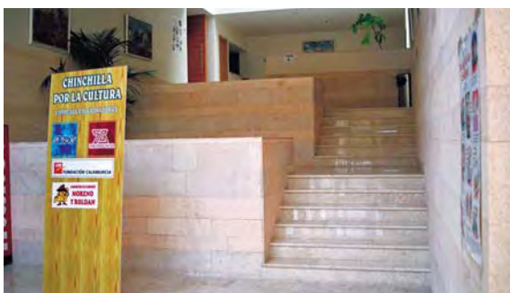
Figura 308. Escalera sin pasamanos, pavimento deslizante y mesetas intermedias sin protección. Fuente: Socytec (fotografía).
