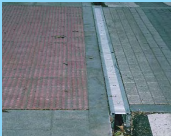
Figura 90. Canaleta lateral para aguas pluviales. Fuente: Socytec (fotografía).
