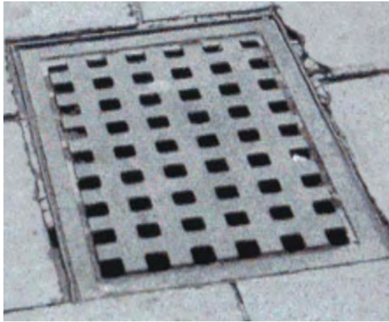
Figura 119. Rejilla en cuadrícula adecuada en Cascos Históricos. Fuente: Socytec (fotografía).
