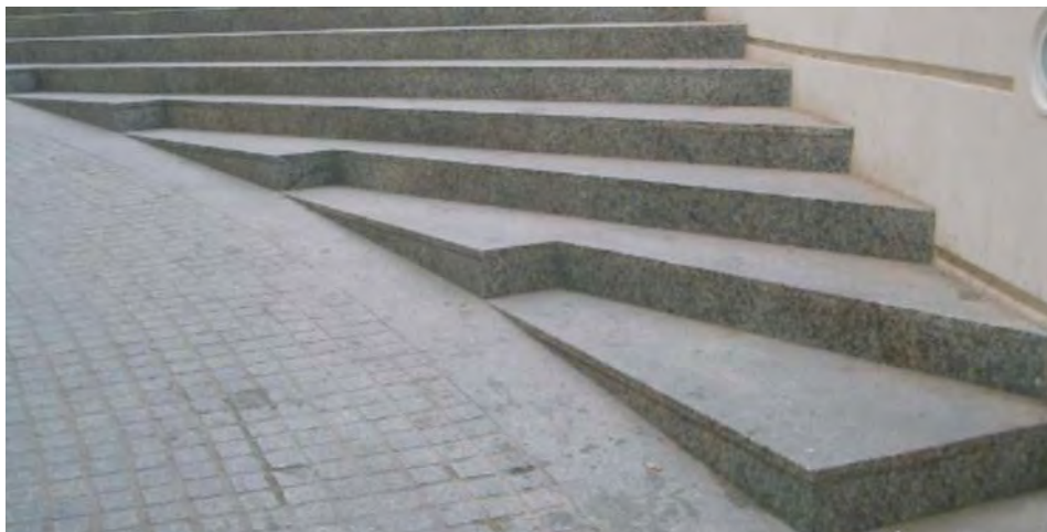
Figura 152. Práctica mejorable: escalones con efecto de falsa continuidad. Fuente: Socytec (fotografía).
