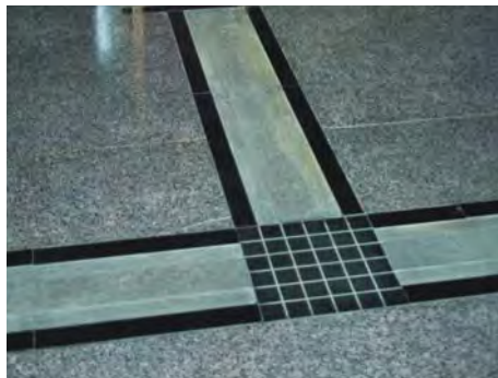
Figura 176. Detalle de un encaminamiento con una pieza de cruce en cuadrícula. Fuente: Socytec (fotografía).
