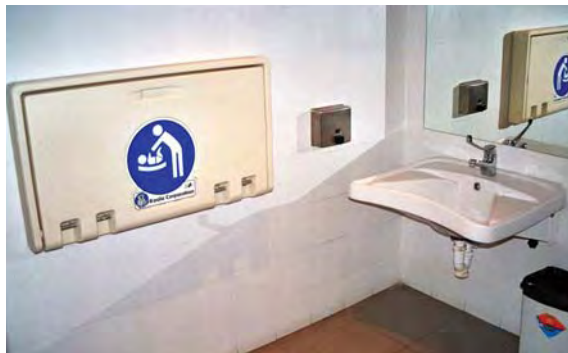
Figura 221 y 222. Servicio higiénico accesible dotado además de superficie abatible para el cambio de pañales a bebés. Fuente: Socytec (fotografía).
