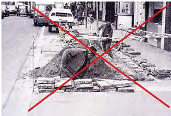
Figura 141. Mala delimitación de zona de obras. Fuente: Fundación Rey Balduino.
