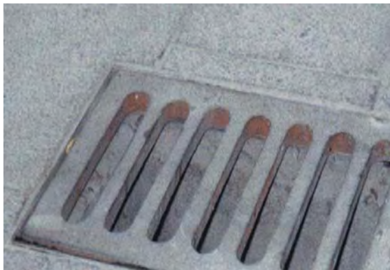
Figura 120. Rejilla no adecuada en relación con los criterios de accesibilidad. Fuente: Socytec (fotografía).
