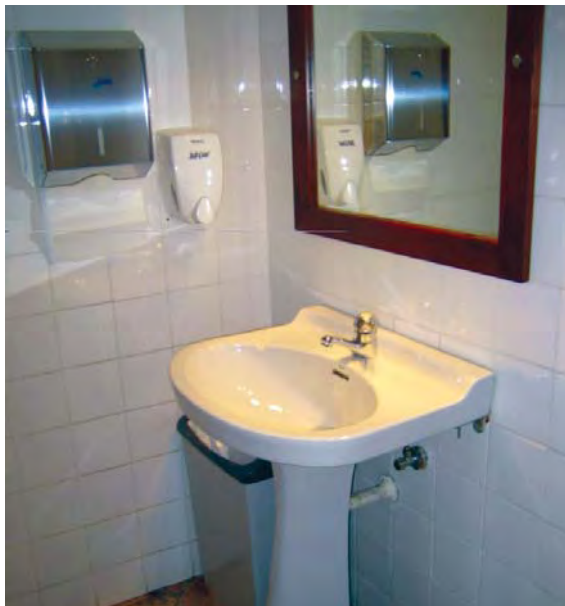
Figura 257. Lavabo no accesible. Fuente: Socytec (fotografía).
