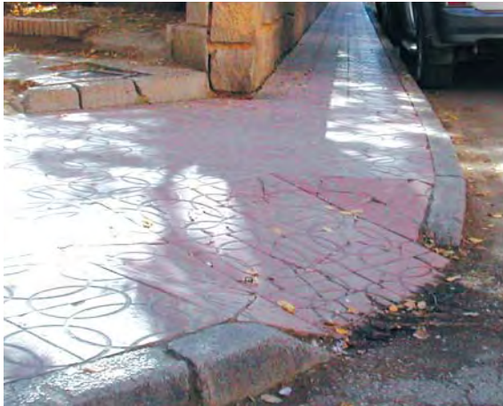
Figura 150. Práctica mejorable: vado estrecho ubicado en una esquina, con el pavimento deteriorado y sin señalización. Fuente: Socytec (fotografía).
