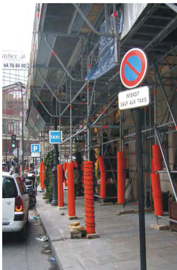
Figura 138. Elementos de protección en andamios. Fuente: Socytec (fotografía).
